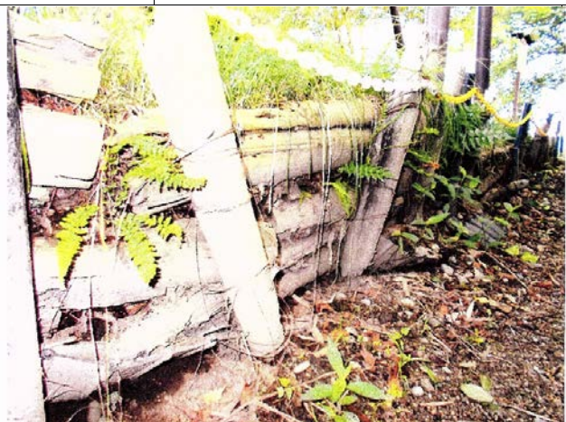
説明 工事前の土手崩れ
